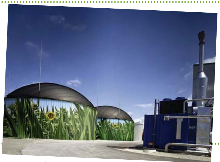
Bioreaktor (links) mit Kraftwerk (rechts)
