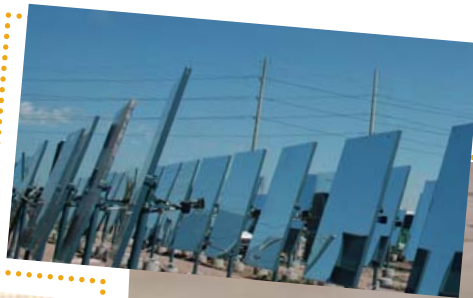
Spiegel des Solarturmkraftwerks
